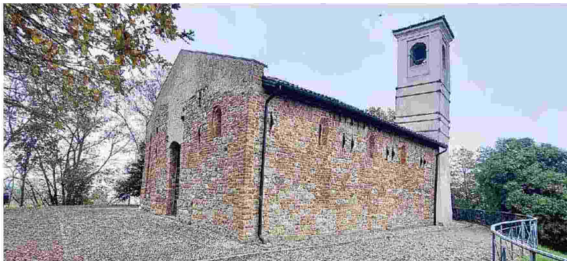
L'antica basilica romanica di Montalino sulle colline di Stradella: le infiltrazioni d'acqua dal tetto stanno creando problemi
