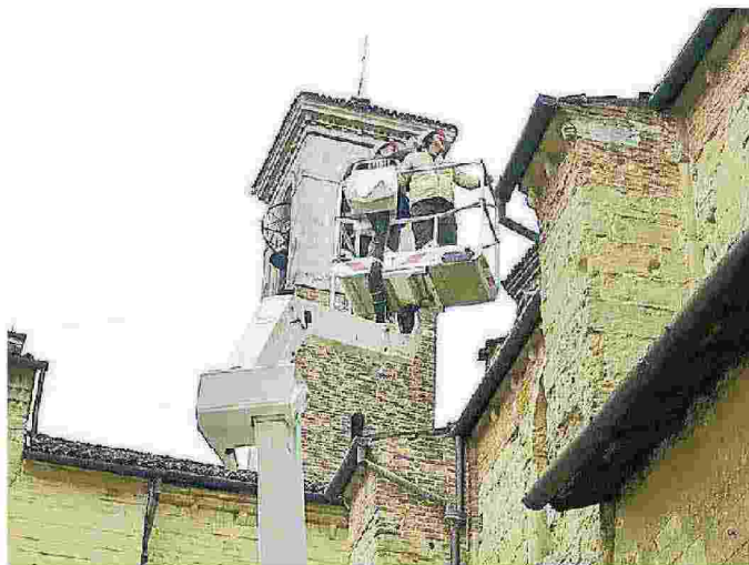
Tecnici al lavoro per controllare la basilica di San Michele
